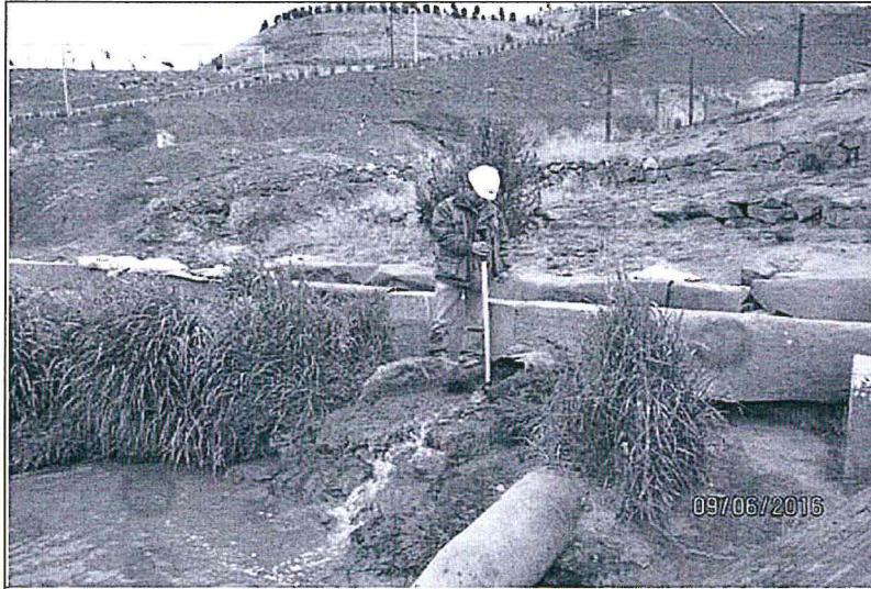
Fotografía N° 17. Hallazgo N° 1.- Descarga de agua canalizada a través del stock pile, hacia el río Ragra en el punto con coordenadas DATUM WGS84 8819582N 361474E.
