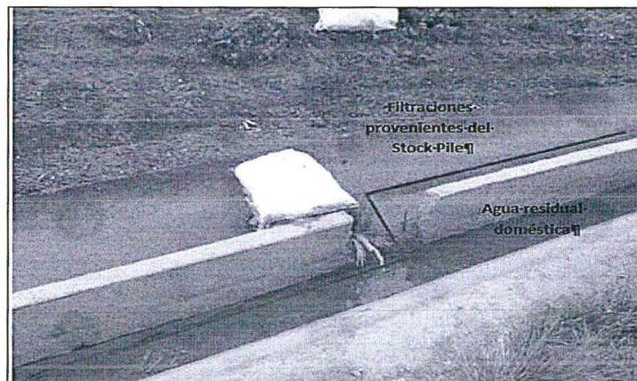
Fotografía-N°-22.-> Hallazgo-N°2.-En el lado del canal de colección y conducción de agua que contiene las filtraciones del Stock-Pile, se observó que el apilamiento de costales con tierra derivaba el agua hacia el lado que conduce agua residual doméstica debido a que el tabique central se encontraba roto.■
