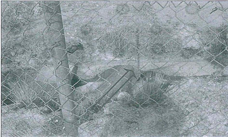
Fotografía N° 13. Hallazgo N° 1.- Descarga de agua residual doméstica proveniente del sector José Carlos Mariátegui hacia el canal perimetral del Depósito de Desmonte Hanancocha. Este hecho fue verificado en el punto con coordenadas DATUM WGS84 8819859N 360646E.
