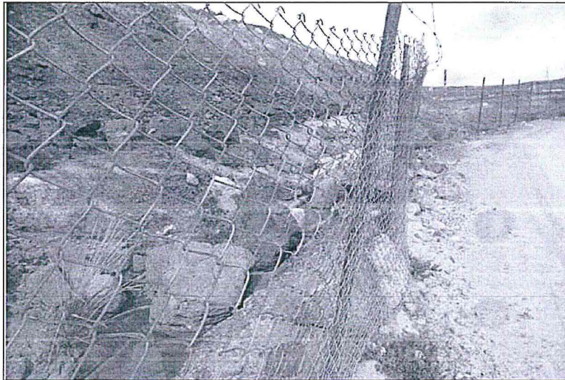
Fotografía N° 25. Hallazgo N° 3.- Canal perimetral de concreto que conduce agua de contacto del Depósito de Desmonte Hanancocha, se encontró colmatado con material deslizado desde dicho componente. El hecho fue verificado en el punto con coordenadas Datum WGS84 8819848N 360467E.
