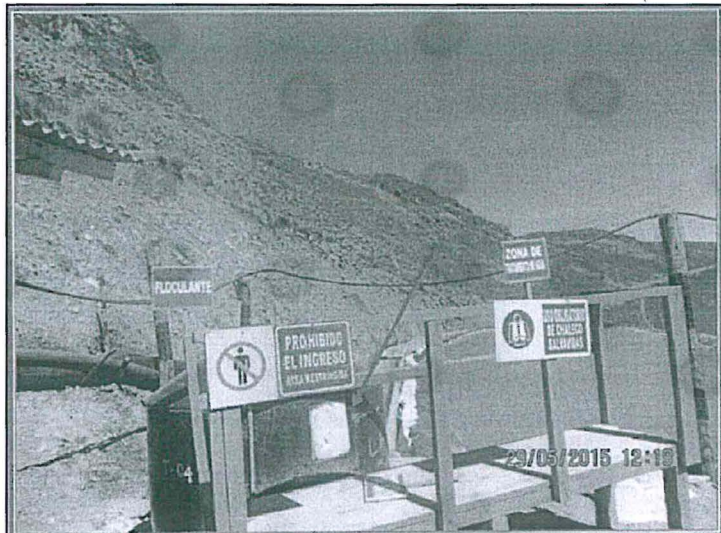
Fotografía N° 13: Tanque donde va el floculante para el sistema de sedimentación o componente A-34.
