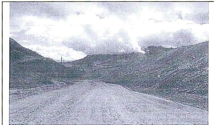
Foto 1. Eliminación de los canales que cruzan el acceso y se derivan al canal de coronación del Botadero de Desmonte 2.
