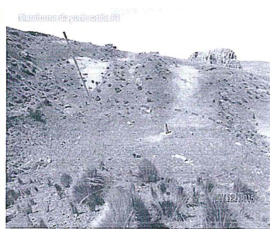
Fotografía N° 027: El área de la plataforma de perforación P3 se encontraba sin perfilar y sin revegetar. Asimismo se observó 2 sondajes, con 2 tuberías de PVC, ambos en un bloque de concreto (Coordenadas UTM WGS84: E 408 887; N 8 396 685).
