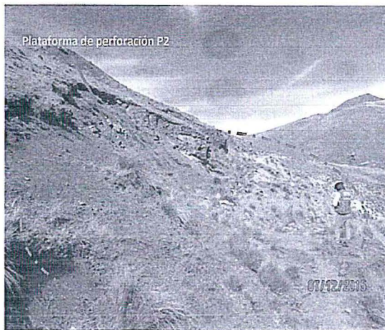
Fotografía N° 050: El área de la plataforma de perforación P2 presenta corte en el talud, asimismo, no se encontraba perfilada, ni revegetada (Coordenadas UTM WGS84: E 408 834; N 8 396 601).
