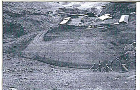
Fotografía N° 4. Otra vista fotográfica que muestra la delimitación de la Cancha provisional de Mineral, con la instalación concluida de la geomembrana, además de los postes de delimitación y la cumeta de coronación respectiva.
