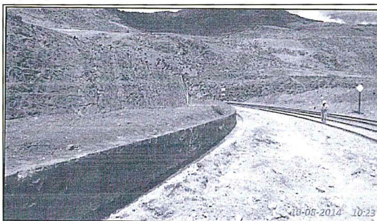
Fotografía N° 1.- Se evidencia que en su momento dicha tubería de aguas de escorrentía (captación de agua de no contacto), fue anulado.
