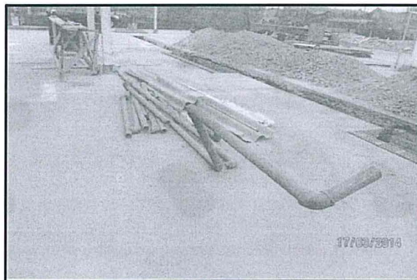
Imagen N° 1: Tuberías de conexión en el patio de maniobras
