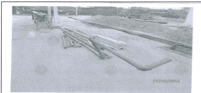
Fotografía N° 3: Se puede apreciar las tuberías de conexión al tanque de combustible líquido de kerosene, en el patio de maniobras.
