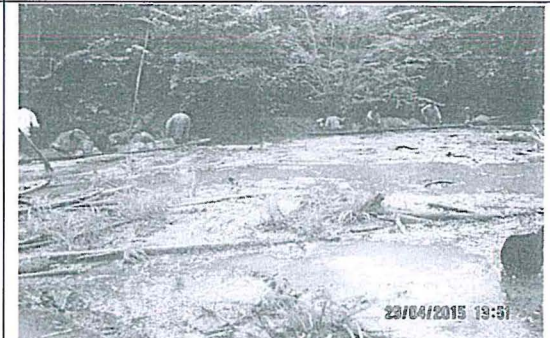
Fotografía N° 10. Descripción: Vista de Barreras de contención, mediante palos y palmeras, para retener y recuperar el hidrocarburo derramado. El punto observado es en la Quebrada Yarina.
