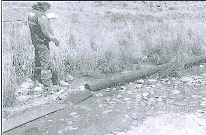
Fotografía N° 185: Hallazgo N° 2, En el área de la poza Top Soil N° 3, en las coordenadas UTM Datum WGS84: 9122448 N y 0804364 E, se evidenció, que la tubería que conduce el agua de contacto del botadero de desmonte este, descargaba al suelo sin impermeabilización, a un costado de la vía de acceso a la poza Top Soil N° 3.
