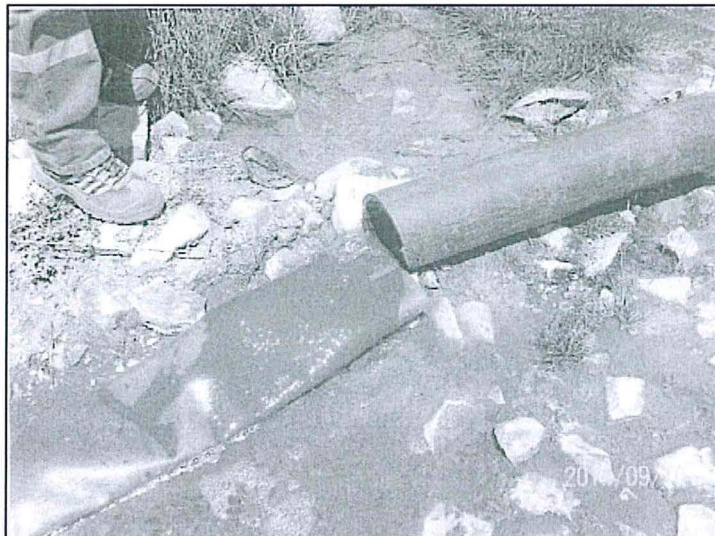
Fotografía N° 186: Hallazgo N° 2, se evidenció, que la tubería que conduce el agua de contacto del botadero de desmonte este, descargaba al suelo sin impermeabilización, se observa que la tubería negra vierte al suelo.
