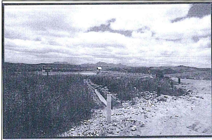
Fotografía N° 2: Sistema de cunetas a lo largo de las pozas existentes Fuente: Minera Barrick Misquichilca S.A.
