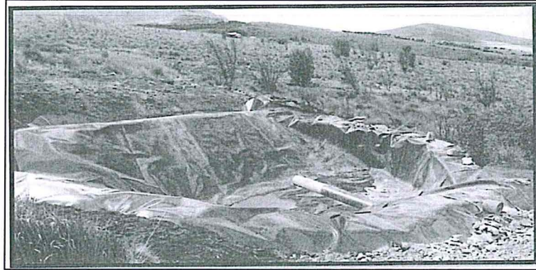
Fotografía N° 8: Poza revestida con geomembrana Fuente: Minera Barrick Misquichilca S.A.
