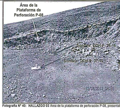
Fotografía N° 40: HALLAZGO 03 Área de la plataforma de perforación P-08, presentaba talud de corte expuesto y en la base de la plataforma se evidenció plantones de ichu. Asimismo se observó dos sondaje con su bloque de concreto y tubo de PVC, identificados con código DDH-36-16 y DDH-37-16.
