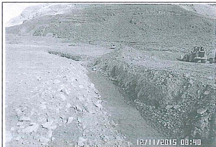
Fotografía N° 37: Vista de la zanja de tierra que capta el agua que drena del depósito de relaves Chanca, coordenadas UTM WGS84 8831881N, 293909E. Hallazgo N°04.
