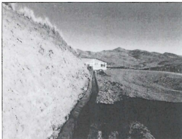
Fotografía N° 11: Canal de coronación impermeabilizado.
