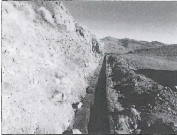
Fotografía N° 9: Canal de coronación impermeabilizado.
