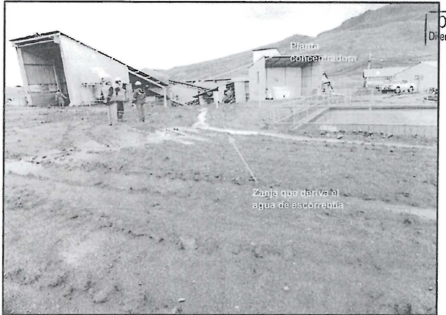
Fotografía N°14: Vista fotográfica de la planta concentradora donde se aprecia una zanja que deriva el agua de escorrentía hacia la vía de acceso.
