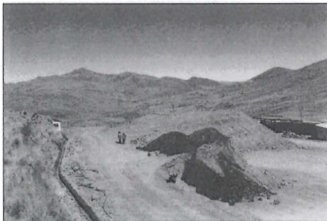
Fotografía N° 14: Canales de derivación impermeabilizados.
