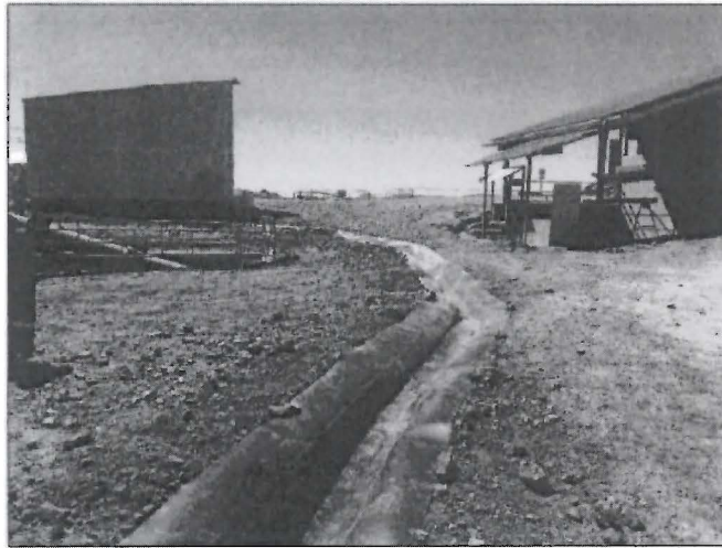
Fotografía N° 13: Canal de coronación impermeabilizado.
