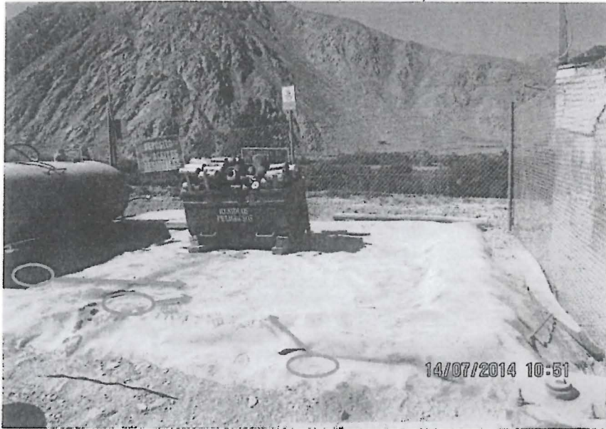
Fotografía N° 82: Hallazgo N° 8, supervisión julio 2014, el sistema de contención de los aceites residuales presenta roturas en la geomembrana, lo cual no garantiza retención de hidrocarburos en caso de fugas, (N: 8240418, E: 0708541).
