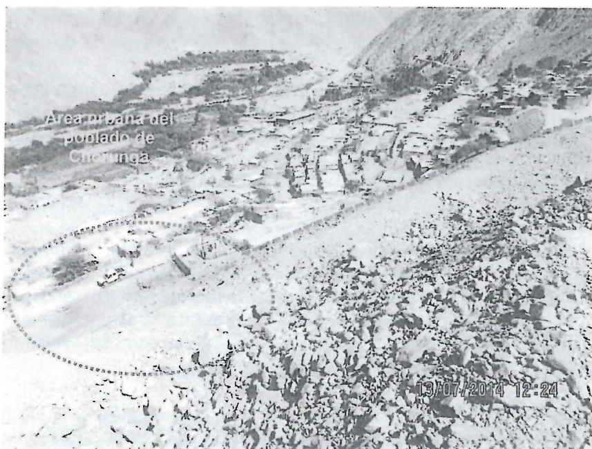
Fotografía N° 70: Hallazgo N° 3 - Supervisión julio 2014, vista de los taludes del depósito de desmonte Nv. 150 sin canal de coronación, próximos al área urbana de la población de San Juan de Chorunga. (N: 8241121 y E: 0709054).
