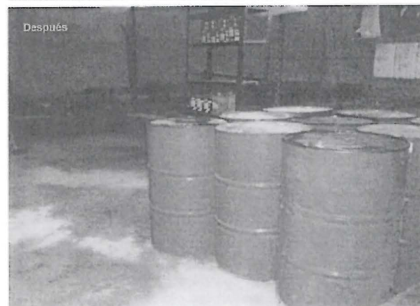
Fotografía N° 85: Halleazgo N° 9, supervisión julio 2014, se observó la existencia de motobombas conteniendo combustible ubicado en terreno sin impermeabilizar. (N. 8240744, E: 0708782).
