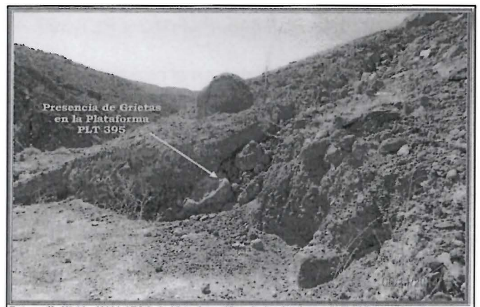
Fotografía N° 12: HALLAZGO 1: Vista fotográfica de la plataforma PLT 395, se observa que la plataforma no se encuentra nivelada y existe la presencia de grietas que caen a la plataforma PLT 395..
