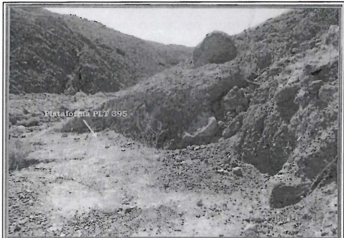
Fotografía N° 11: HALLAZGO 1: Vista fotográfica de la plataforma PLT 395, el cual no se encuentra nivelada.
