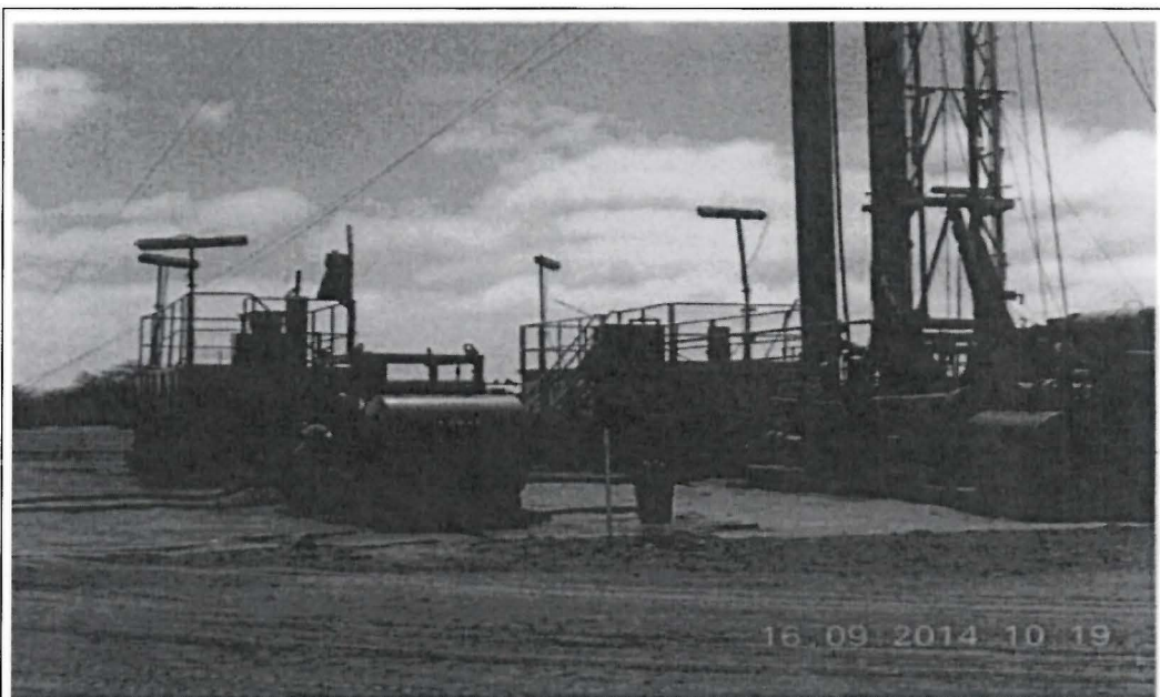
Fotografía N° 3. Se observa un lado de la plataforma, la base donde se ubican los equipos de cementación está cubierta por una geomenbrana, sin embargo no se observa canales de drenajes.
