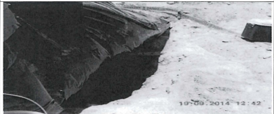
Fotografía N° 8. Vista interna de la poza séptica N° 2; la misma que está tapada con plástico y soportado por parantes de madera(poza artesanal).
