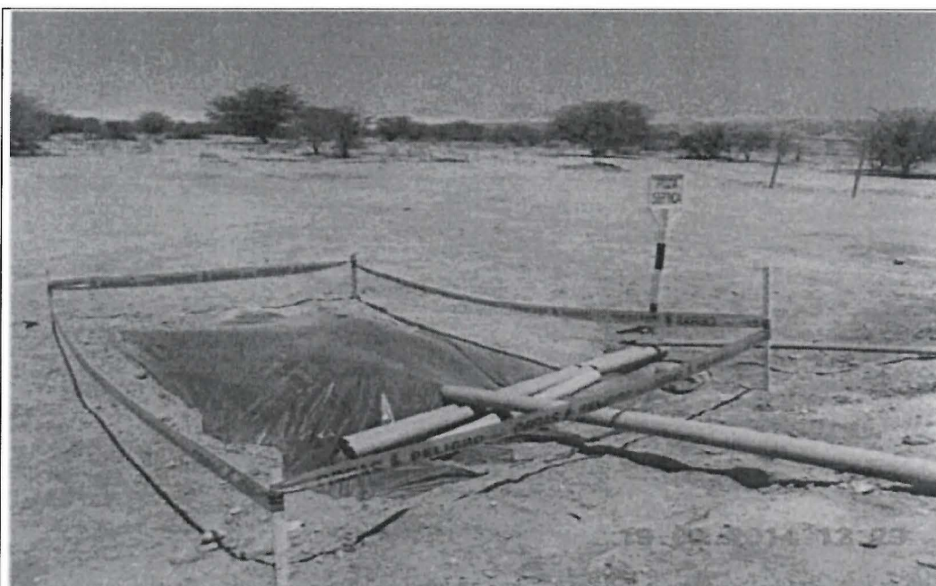
Fotografía N° 5 Vista de la poza séptica N° 1, ubicada en la parte posterior de la zona de lavandería y comedor el pozo Illescas 12X.
