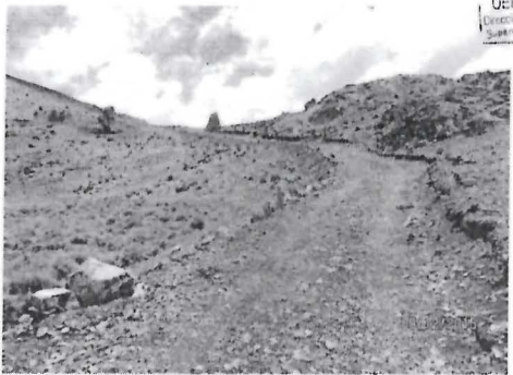
Fotografía N° 027: La vía de acceso a la plataforma de perforación 20 se encontraba sin perfilar y sin revegetar, asimismo presentaba rocas sueltas. (Coordenadas UTM WGS84: E 375 487, N 8 394 329)
