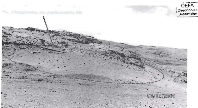
Fotografía N° 025: El área de la plataforma de perforación 20 se encontraba sin perfilar y sin revegetar (Coordenadas UTM WGS84: E 375 415; N 8 394 288).
