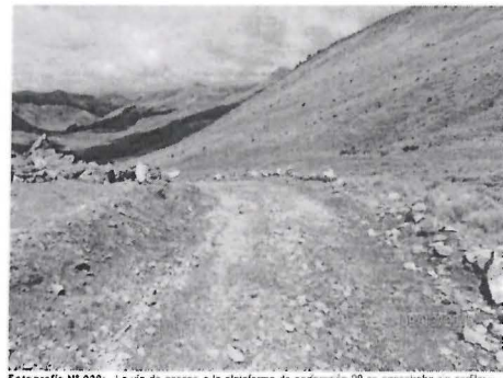
Fotografía N° 028: La vía de acceso a la plataforma de perforación 20 se encontraba sin perfilar y sin revegetar, asimismo presentaba rocas sueltas. (Coordenadas UTM WGS84: E 375 487, N 8 394 329)
