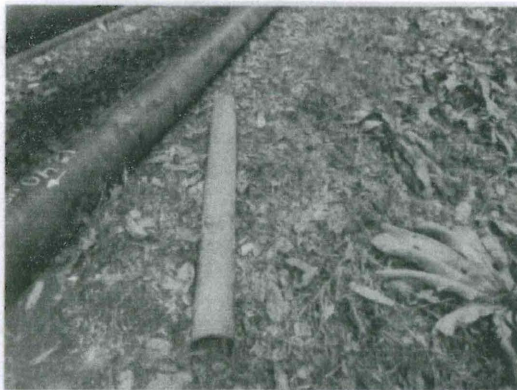
FOTO N° HRS.019: Oleoducto Capahuari Sur - Gathering. Se observa una tubería de 2" de diámetro y 1,6 m de longitud, dispersada sobre el derecho de vía del oleoducto.
