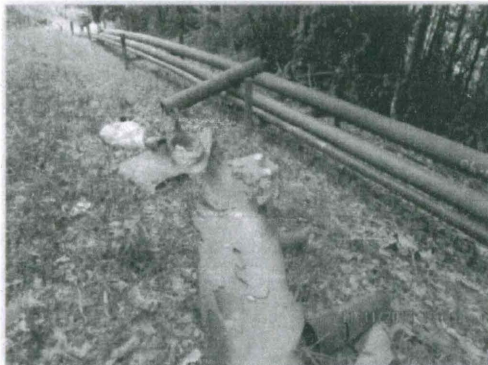
FOTO HRS.098: Restos de forros de tubería sobre el derecho de vía de flowline norte (pozo 6) - San Jacinto.
