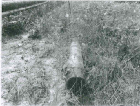
FOTO N° HRS.004: Oleoducto Capahuari Norte – Capahuari Sur Se observa una tubería de 4" de diámetro y 2 m de longitud, dispersada sobre el derecho de vía del oleoducto.
