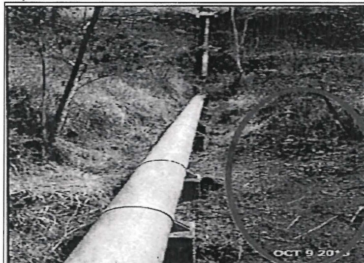
Fotografía N° 18: Vista fotográfica donde se observa la huella de quema colindante a la tubería forzada de la CH Pucará
