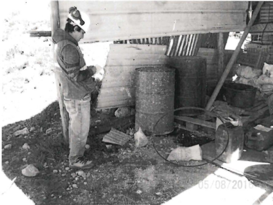
Fotografía N° 9. Vista de la presencia de derrame de hidrocarburos sobre suelo natural. Ubicado en las coordenadas UTM WGS 84 Zona 18 E 169 820 N 9 106 356. (HALLAZGO N° 1)
