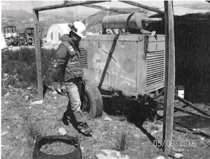
Fotografía N° 15. Vista del área donde se encontraba ubicado el generador eléctrico, dicha área se encontraba construida con maderas, geomembrana y parihuelas, dentro del cual se observó al grupo electrógeno, el suelo no se encontraba impermeabilizado. Ubicado en las coordenadas UTM WGS 84 Zona 18 E 169 838 N 9 106 363.
