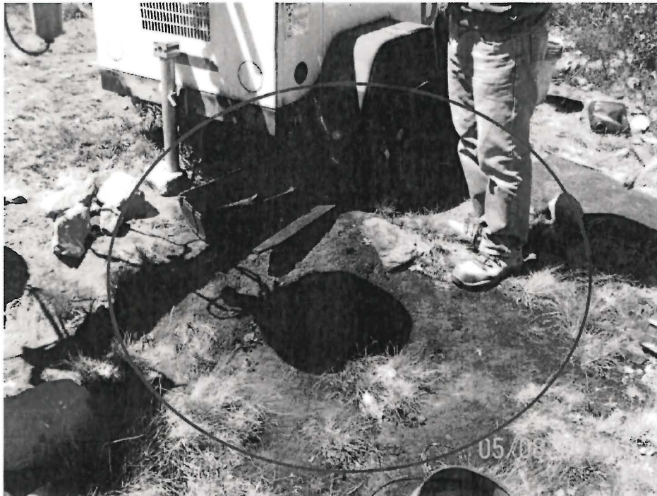
Fotografía N° 13. Vista del equipo de iluminación, el cual presentaba derrame de hidrocarburos sobre un depósito de plástico y sobre el suelo natural. Ubicado en las coordenadas UTM WGS 84 Zona 18 E 169 829 N 9 106 357. (HALLAZGO N° 3)
