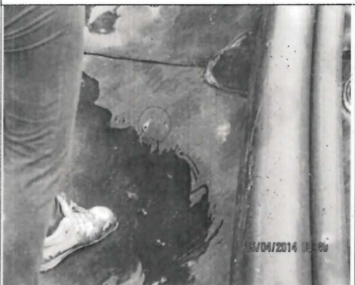
Fotografía N° 475: Geomembrana perforada en el canal sobre el cual se encuentra la línea de conducción de solución lixiviada de la pila de lixiviación Yanacocha, al costado del tanque de recirculación y adyacente a la pila de operaciones.
