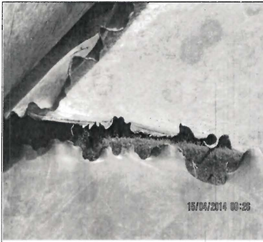
Fotografía N° 469: Geomembrana rasgada en el canal sobre el cual se encuentra la línea de conducción de solución lixiviada de la pila de lixiviación Yanacocha.
