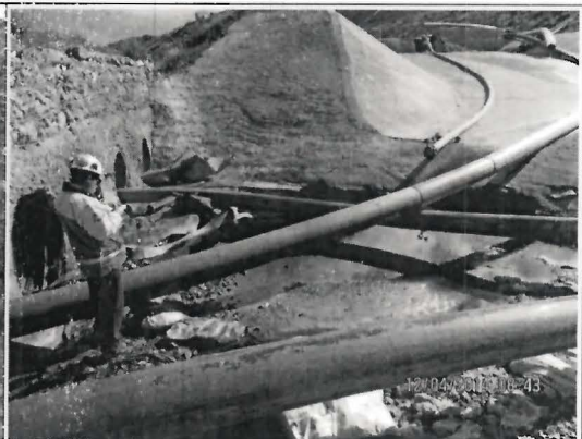
Fotografía N° 59: Canal de revestimiento donde descarga la poza previa Cajamemba, se observa agua ácida empozada.
