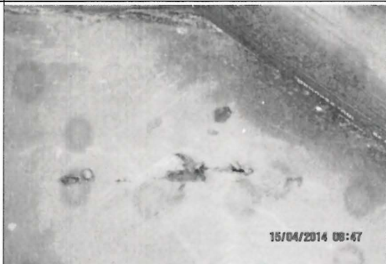
Fotografía N° 474: Geomembrana perforada en el canal sobre el cual se encuentra la línea de conducción de solución lixiviada de la pila de lixiviación Yanacocha, al costado del tanque de recirculación y adyacente a la pila de operaciones.
