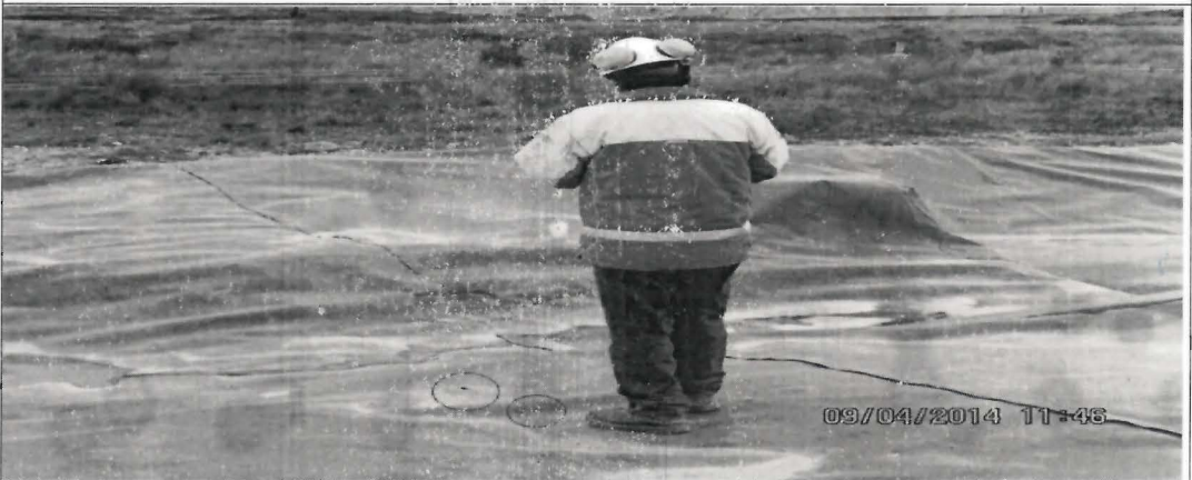
Fotografía N° 10: Geomembrana perforada en el canal de descarga de la tercera poza de sedimentación del canal de interceptación de agua superficial del lado oeste del tajo La Quinua 3 que deriva el agua de lluvia y subdrenaje del depósito de topsoil Ornamo hacia la quebrada Callejón.
