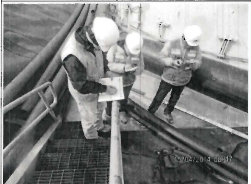
Fotografía N° 470: Canal sobre el cual se encuentra la línea de conducción de solución lixiviada de la pila de lixiviación Yanacocha y el tanque de recirculación ubicado adyacente a la pila de operaciones de la pila de lixiviación Yanacocha.
