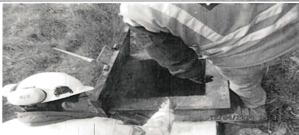
Fotografía N° 783: Caja de paso donde se ha producido el rebalse de agua con hidrocarburos |
