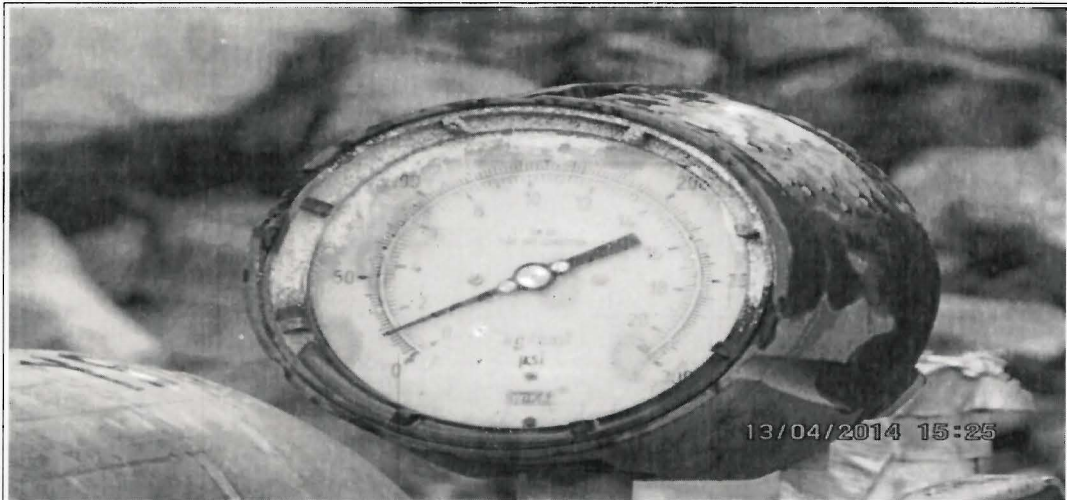
Fotografía N° 132: Manómetro el sistema de bombeo del pozo YSPW-07, registra una presión de 1 PSI por la columna de agua que se mantenía en la tubería. No se realizaba el bombeo de agua subterránea.
