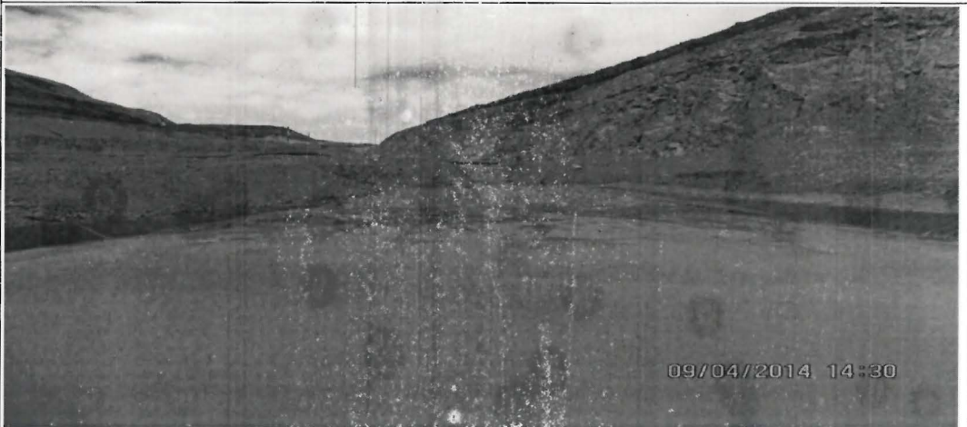
Fotografía N° 43: Poza de sedimentación colmatada por falta de mantenimiento en la zona Rosa Loca, en el límite del tajo La Quinua con el tajo Yanacocha.
