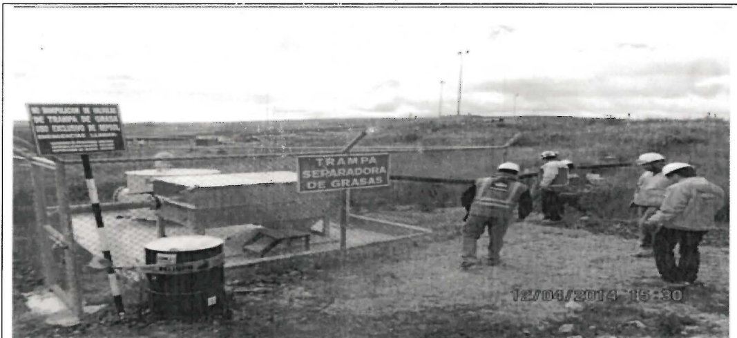
Fotografía N° 781: Trampa separadora de grasa ubicada adyacente de la zona de almacenamiento de combustibles de La Quinua.
