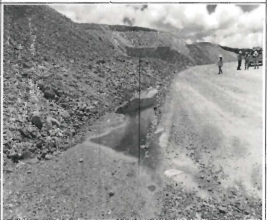
Fotografía N° 327: Agua ácida empozada en la cuneta de la vía de acceso ubicada adyacente al depósito de desmonte Chiquiracha, lado sur.
