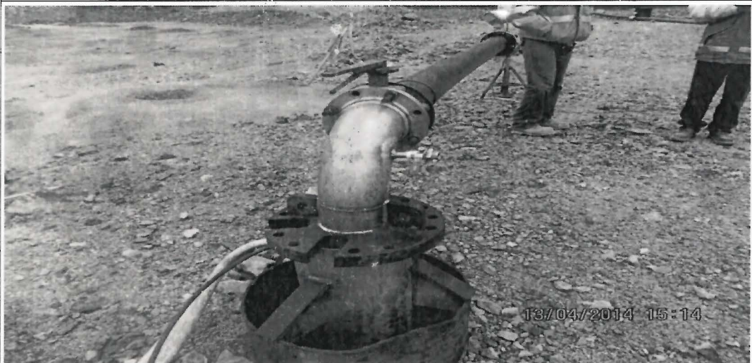
Fotografía N° 135: Pozo de agua subterránea YSPW-09 ubicado dentro del tajo Yanacocha Sur. La bomba no se encontraba operativa.
