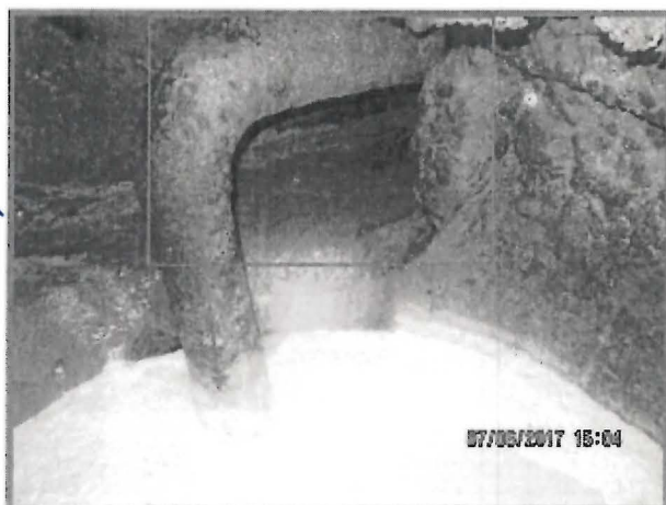
Foto N° 50: Vista interna de la Poza trasvase que se conduce los efluentes tratados del emisor submarino. Lo señalado con el cuadro de color rojo es el ingreso de la canaleta de agua de limpieza. La flecha de color rojo señala la tubería que conduce la purga de calderos.
