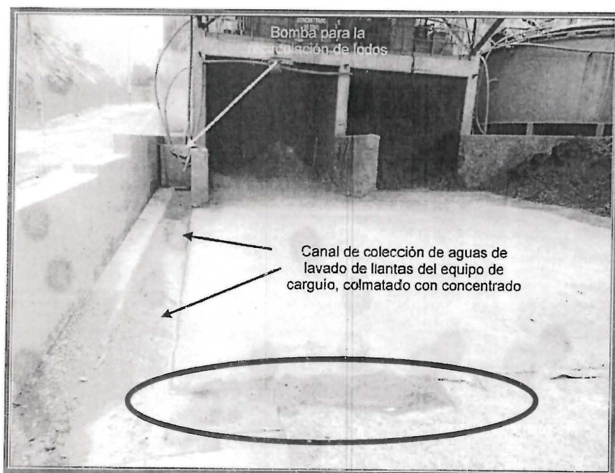
Fotografía N° 83: Depósito de concentrados de Plomo. En la plataforma de estacionamiento de camiones para el carguío de concentrados de Plomo, el canal de colección de las aguas de lavado de llantas del equipo carguío, se encuentra colmatado con concentrados.
