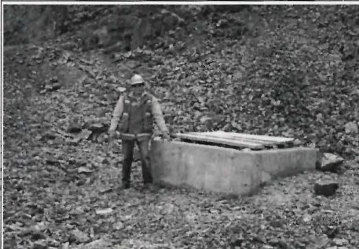
Fotografía N° 48. Chimenea N° 2 ubicada en el punto con coordenadas UTM WGS 84 N: 8379022 E: 701353, está pendiente de cierre de acuerdo a lo establecido en los planes de cierre de minas presentado por el administrado.
