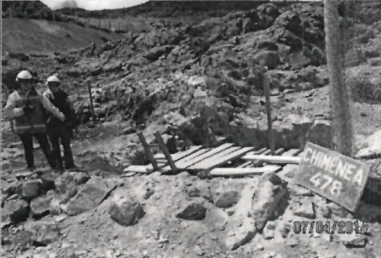
Fotografía N° 52. Chimenea 478 ubicada en el punto con coordenadas UTM WGS 84 N: 8378991; E: 701254, se observa pendiente de cierre.
