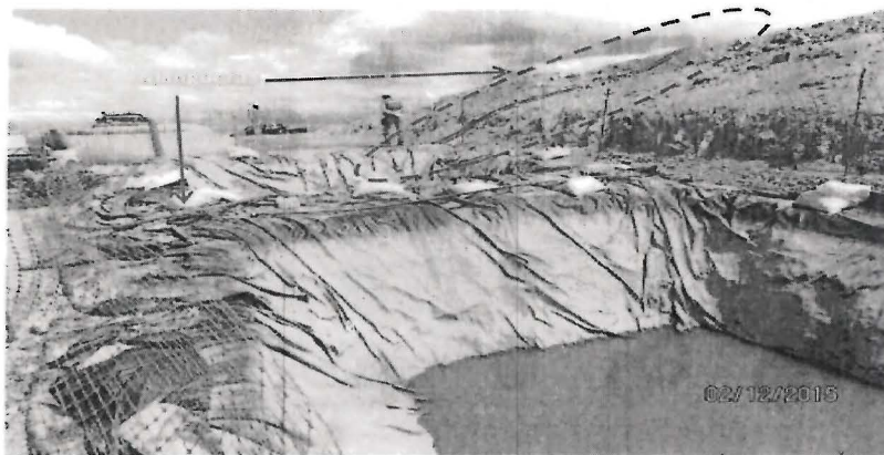
Fotografía N° 130: Se observaron mangueras instaladas y sumergidas dentro de las pozas y peras para almacenamiento de agua que serían captadas de la laguna Yanacocha (Coordenadas UTM WGS84: E 359 670; N 8 430 396).
