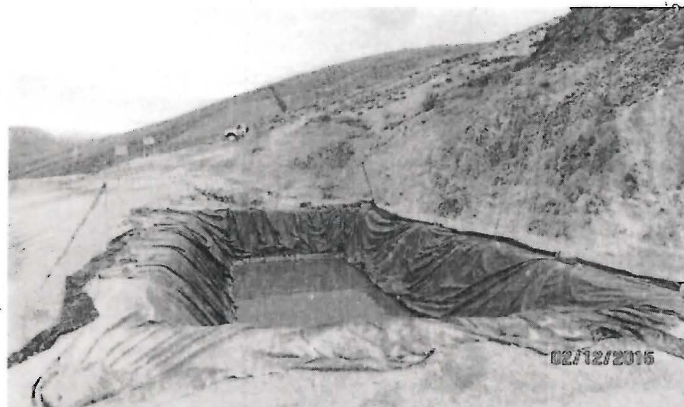
Fotografía N° 099: Se observó 3 pozas de sedimentación delimitados con una malla anaranjada. (Coordenadas UTM WGS84: E 360 199; N 8 430 470).
