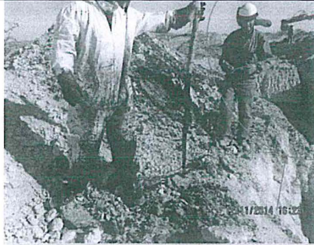
Foto N° 06-B: N 9349164, E 509350 En la fotografía se observa, la poza de contención de petróleo crudo, se encuentra excavada aproximadamente a 5 m. al lado noreste del punto del lugar del incidente. Coordenadas UTM (WGS84) N 9349164, E 509350
