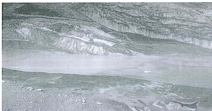
Foto 24: Vista de Geomembrana Reparada en la Zona Este de la Relavera Oasis
