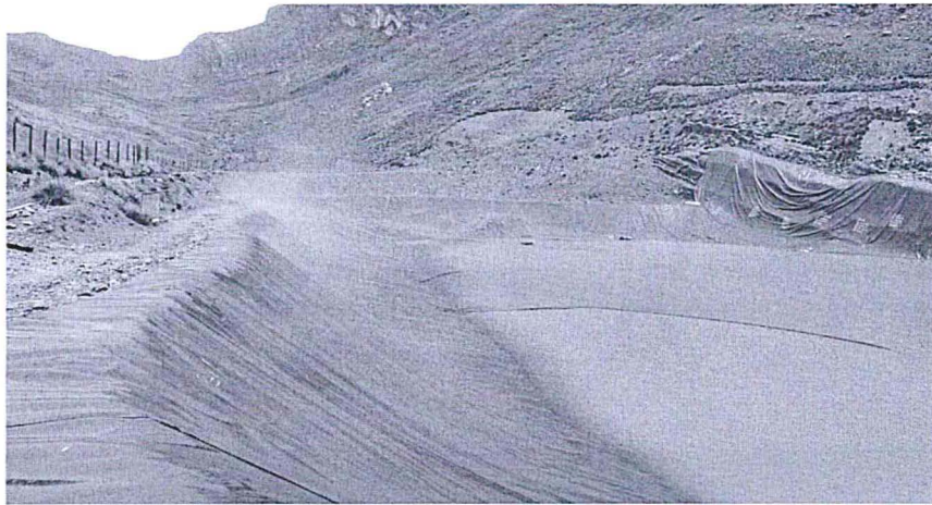
Foto 24: Vista de Geomembrana Reparada en la Zona Oeste de la Relavera Oasis
