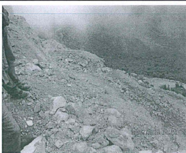
Fotografía N°5. El tajo Pampa Verde no cuenta con canal de captación y derivación de aguas de escorrentía en la parte Nor Este en las coordenadas UTM WGS84 N 9245840, E 730596 y N 9245871, E 730504, asimismo se observó material de desbroce sobre la vegetación en esa zona. Hallazgo N° 1.
