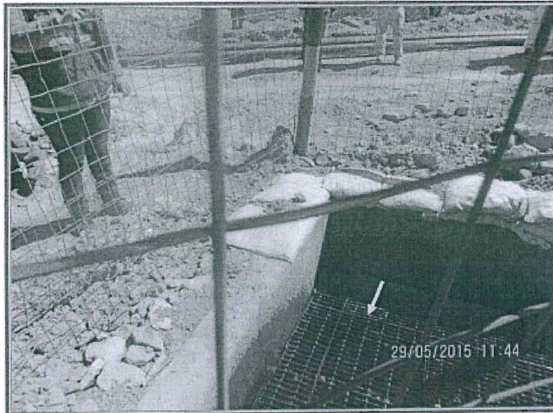
Fotografía N° 4: Otra vista de la caja de registro, desde donde se descarga hacia la quebrada Petari el efluente tratado.
