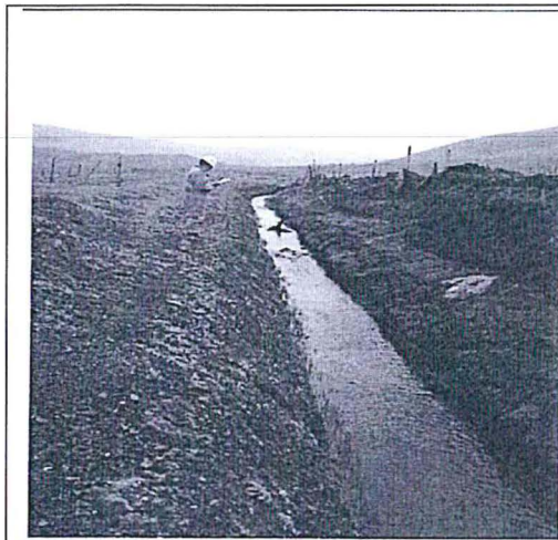
Fotografía N° 2.- Canal de derivación izquierdo no revestido de aguas superficiales y de escorrentía de la laguna Quilcaymachay. UTM Datum WGS 84: 8819018 N y 359050 E
