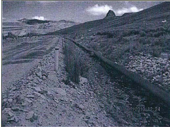
Fotografía N° 33: Conducción del drenaje ácido de roca del depósito de desmonte en un canal enrocado sin recubrimiento impermeable que reduzca el riesgo de filtración.
