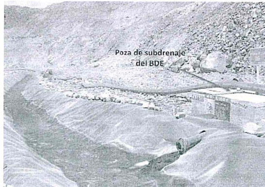
Fotografía N° 16: Caja de colección de subdrenaje N° 6 de concreto, con su respectivo letrero, por el cual se descarga las aguas de filtración al canal perimetral del Botadero de Desmonte (BDE), que las conduce a la Foz ARD.
