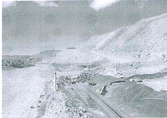
Fotografía N° 14: El canal perimetral del Botadero de Desmonte se encuentra operativo. Esta recubierto con geomembrana para la conducción de la escorrentía y filtraciones hacia la Foz ARD.
