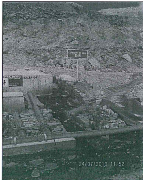
Fotografía N° 36: Punto de colección del Drenaje Ácido de Roca, el cual se conduce hacia una poza de colección de aguas ácidas.
