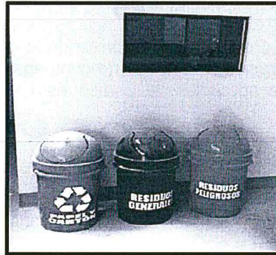
Instalación de tachos segregadores de residuos azul (papel y cartón), negro (generales) y rojo (peligrosos) ubicados al interior de la sala de tableros de SET Jesús.
