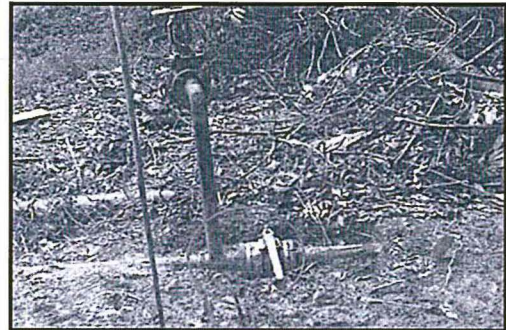
Fotografía N° 2: Vista de la válvula de la línea de Diésel de 2", de la cual sale la línea hacia la Locación Tambo Sur, donde se ubica el pozo Tambo Sur 01X (abandonado).
