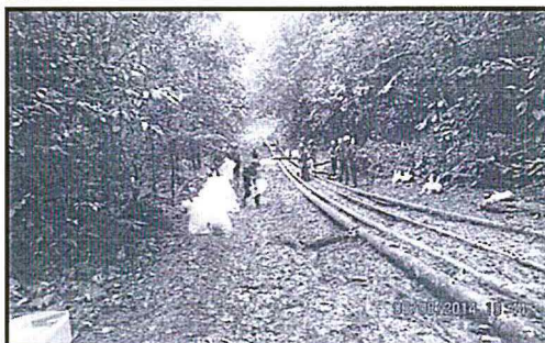
Fotografía N° 3: Zona impactada por la fuga de diesel.
