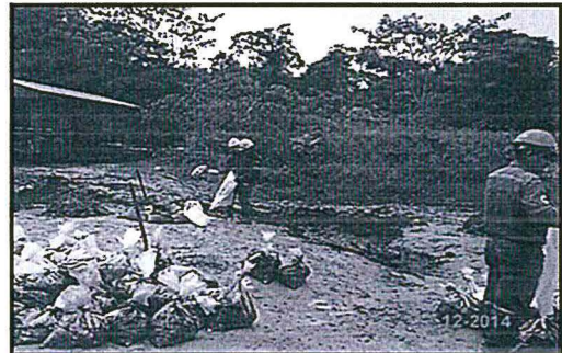
Fotografía N° 18: Detalle del recojo de suelos contaminados con Hidrocarburos. En este lugar se iban recogiendo aproximadamente 50 bolsas de suelos contaminados con hidrocarburos. Coordenadas: 367395E, 9696822N.
