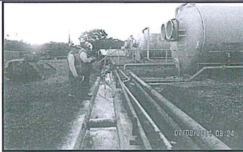
Fotografía N° 1: Zona de fuga de crudo junto a Separador N° 5 – Bateria Shiviayacu.
