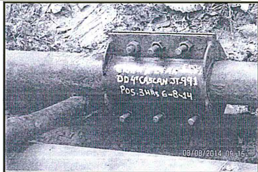
Fotografía N° 2: Punto de fuga de diesel junto al joint 991.
