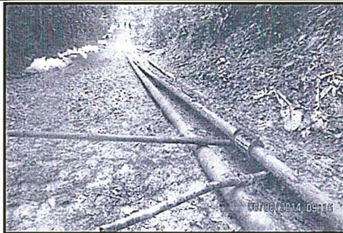
Fotografía N° 1: Zona de fuga de diesel cerca al joint 991.
