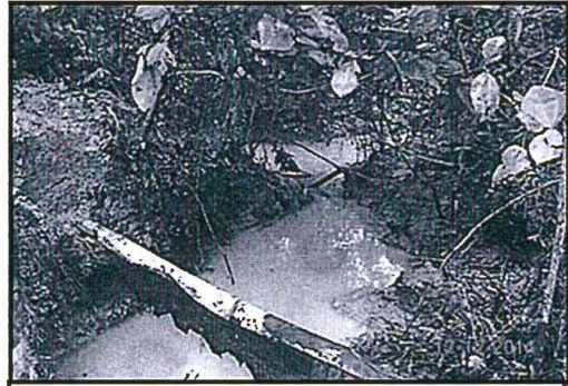
Fotografía N° 10: Detalle del canal de drenaje pluvial (normalmente drena agua de lluvias del tanque de 3,300 barriles y entorno) Para el evento, por este canal parte del hidrocarburo derramado fue dirigido a la quebrada Pucacuro. Coordenadas: 367362E, 9696888N.
