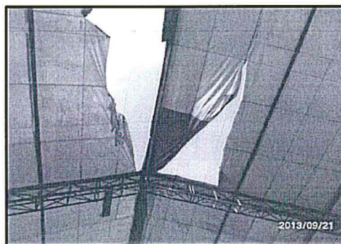
Fotografía 16: Techo deteriorado en CBL – La Peruanita
