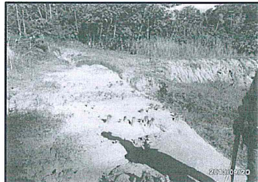
Fotografía 8: Área sin Revegetación Otro extremo del banco desprotegido en talud de la poza de quema Picha 2X
