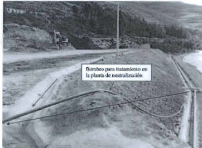
Foto 6: Canales de colección de drenajes del nivel P Sur (N°1), donde se observa el sistema de bombeo
