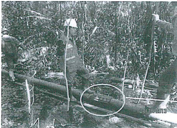
Foto N° 14. Profesional del OEFA en el lugar del incidente ocurrido el 06.04.2013, puede observarse la grapa colocada para contener el derrame de fluidos por el corte. La vista fue registrada el 10.04.2013
