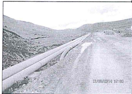
Fotografía N° 5. Vista de las tuberías de conducción de relaves que están instaladas sobre suelo y no cuentan con el sistema de contingencia para posibles casos de derrame y/o fuga de relaves.
