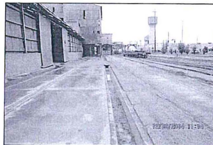
Fotografía N° 13. Vista de la construcción del sistema de colección del agua de lavado.
