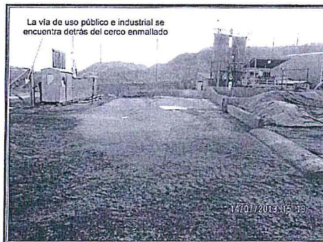
La vía de uso público e industrial se encuentra detrás del cerco enmallado Fotografía N° 84: Planta Concentradora San Expedito. Se constató que la plataforma de cargulo de concentrado de plomo, adyacente al depósito de concentrado, no cuenta con un sardinel de contención para evitar la salida del agua de lavado con partículas de concentrado, al exterior de la plataforma. En el exterior de la plataforma se observa el piso impregnado de partículas de polvo.
