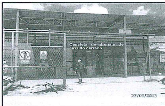
Fotografía N° 13: Vista del Centro de Almacenamiento de Productos Químicos de la Planta Malvinas, obsérvese que en esta parte del área de almacenamiento no cuenta con un pit de contención o muro de contención, pero si tiene una canaleta de drenaje.
