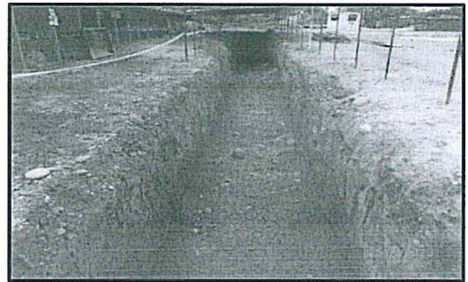
Fotografía N° 4: Vista de la apertura de una nueva fosa 13 de residuos contigua a la fosa operativa. En dicho lugar no se encontró un pozo de monitoreo de agua subterránea.
