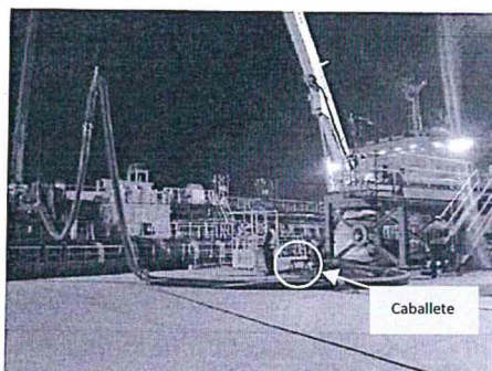
Fotografía N° 166: Embarque de ácido sulfúrico. No se observa el recipiente de PVC para atrapar los posibles goteos.
