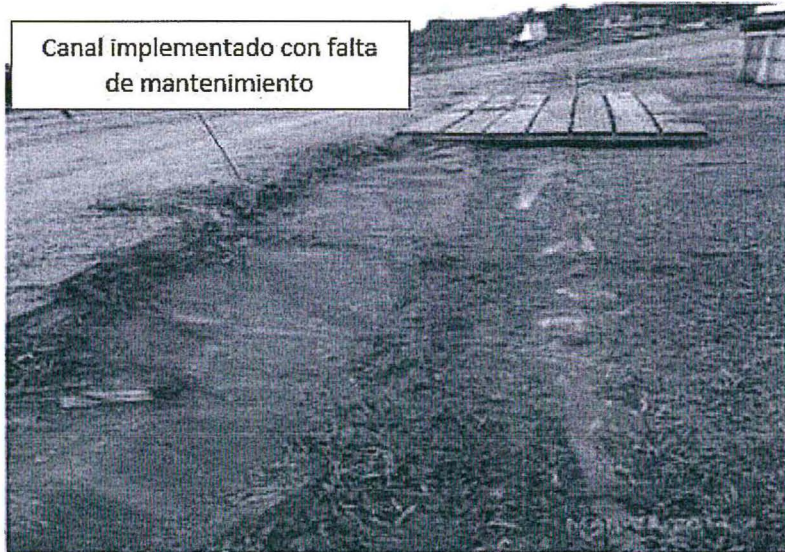
Foto N° 101: Campo Paiche Vista de un tramo de aproximadamente 15 metros del canal de control de drenajes de agua de lluvia, en donde se observa la falta de mantenimiento (LBC Curaray)
