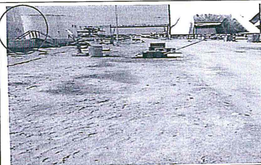
Foto N° 32: Se observan aproximadamente 6 m 2 de suelos afectados con hidrocarburos a lo largo de la línea de desagües que van al API Sur (Coordenada WGS 84 Este: 0468607, Norte 9493527)
