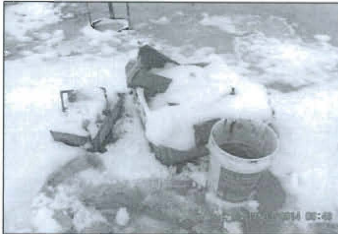
Fotografía N° 378: Aceites residuales en un contenedor abierto en la plataforma de armado. Asimismo se observa residuos de madera, cartón y metal sobre suelo natural.
