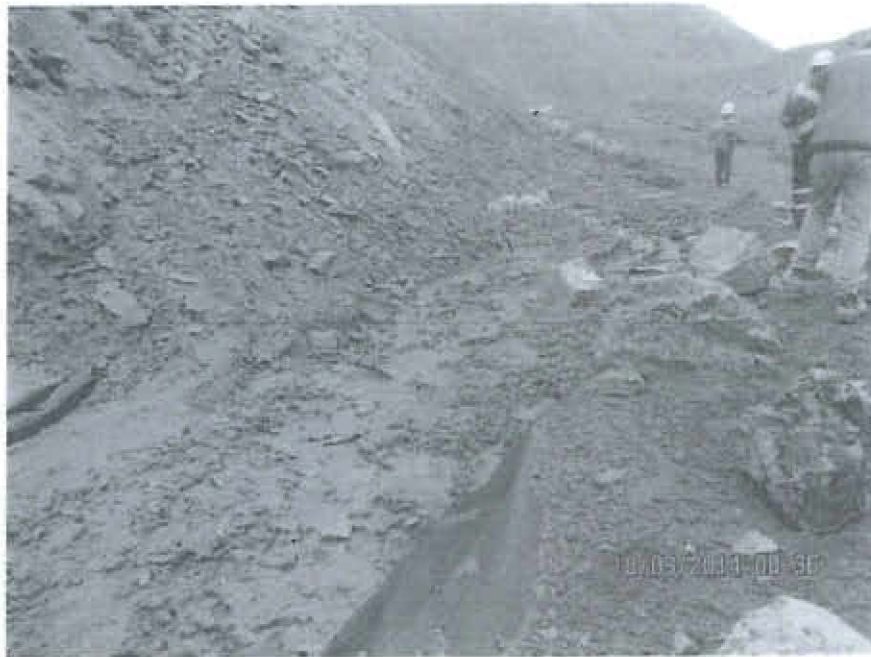
Fotografía N° 93 Canal conestado con material de derrumbe del talud adyacente
