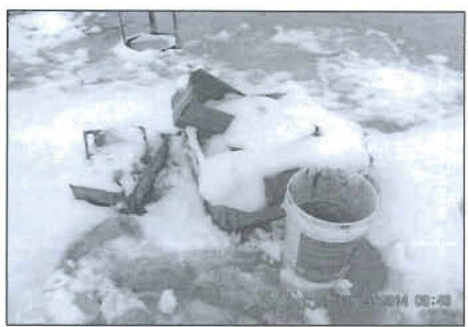
Fotografía N° 378: Aceites residuales en un contenedor abierto en la plataforma de armado. Asimismo se observa residuos de madera, cartón y metal sobre suelo natural.
