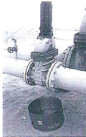
Línea de despacho frente al TK-50
