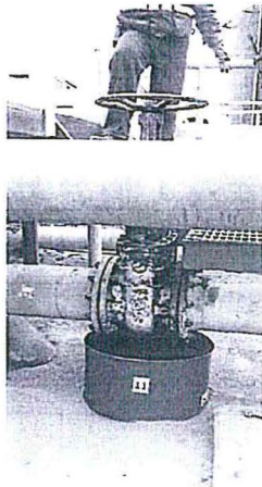
Rack de tuberías altura de la Desaladora
