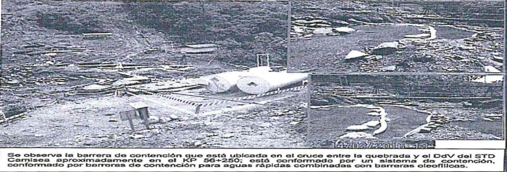
Foto N° 5.10: Barreras de contención en la quebrada Igoritoshiari.
