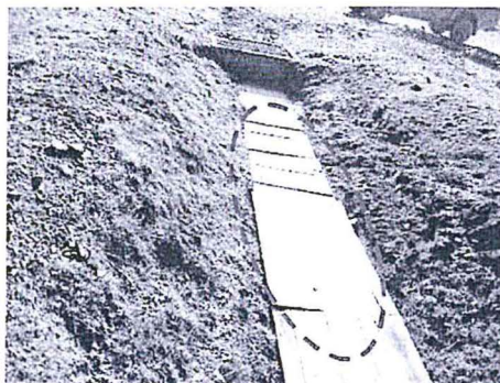
Canal de concreto de descarga hacia la poza N°1, cubierto con tablas de madera.
