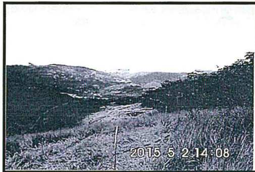
Foto N° 4: Vista Panorámica del KP 183+644 y DDV afectado, la misma que se ha construido sobre ladera. El LGN drena hacia la quebrada Qachqarumi luego a la quebrada Huayrapata que discurre casi paralelo al DDV. La línea roja punteada demarca la zona afectada por el derrame de LGN (4080 m 2 ) Coordenadas UTM: 0656041E, 8570198N
