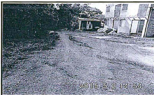
Foto N° 02: Acceso inicial al punto de falla del ducto de LGN. Sobre el acceso se observa grandes grietas que atraviesan el ancho del acceso. Coordenada UTM (WGS84): 656078E, 8569061N
