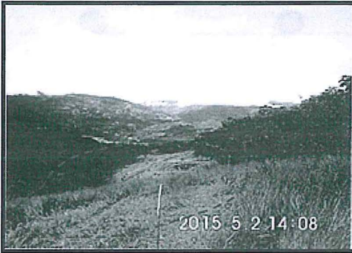
Foto N° 4: Vista Panorámica del KP 183+644 y DDV afectado, la misma que se ha construido sobre ladera. El LGN drena hacia la quebrada Qachqarumi luego a la quebrada Huesyrapata que discurre casi paralelo al DDV. La línea roja punteada demarca la zona afectada por el derrame de LGN (4080 m²) Coordenadas UTM: 0656041E, 8570198N
