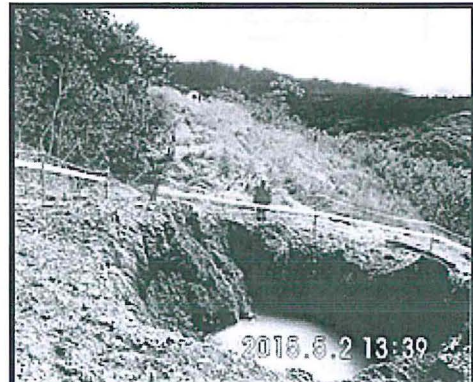
Foto N° 7: KP 183+644 cráter de 5m de diámetro formado por la falla del ducto. Se observa el LGN en un nivel por sobre encima del ducto de 14°. De esta manera el ducto no es posible de observar. Los trabajos de reparación de la sección de ducto dañado se afectarán a partir del día 03.05.2015. (Coordenada UTM WGS84: 0656041E, 8570198N)
