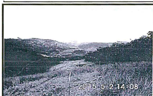
Foto N° 04: Vista Panorámica del KP 183+644 y DDV afectado, la misma que se ha construido sobre laderas. El LGN drena hacia la quebrada Qachasrumi luego a la quebrada Huayrapata que discurre casi paralelo al DDV. La línea roja punteada demarca la zona afectada por el derrame de LGN (4080m 2 ). Coordenada UTM: 0656041E, 8570198N
