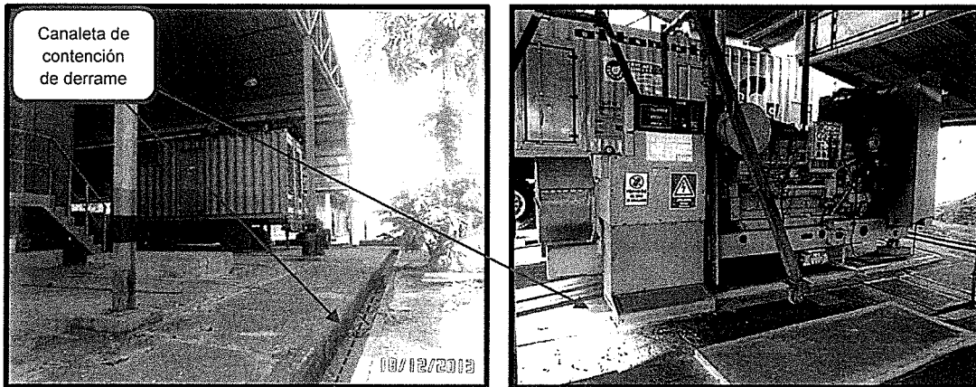
Vista 12 y 15. Grupo Electrónico Cummins 450 kW y CAT 500 kW con su canaleta de contención de derrame ubicados dentro de la casa de máquinas.
