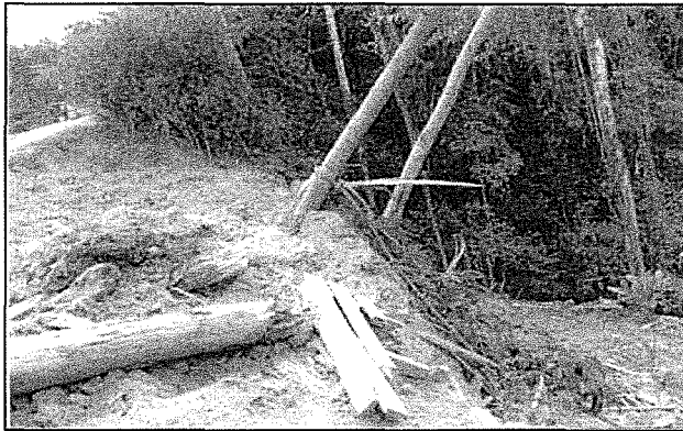
Foto N° 6: Se observa zona de derrumbe impactada por la lluvia existente en la zona que ha permitido el deslizamiento de gran volumen de suelo hacia el abismo, producto de la erosión paulatina, por falta de la aplicación del Programa de Control de Erosión y Revegetación del lugar.
