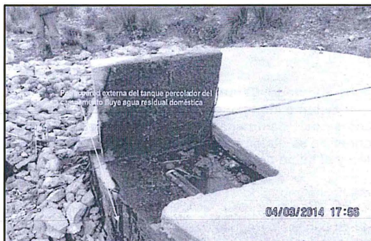
Fotografía N° 37.- Tanque percolador de aguas residuales domésticas cuyas coordenadas en campo son UTM WGS 84: 525448 E, 8570883 N.
