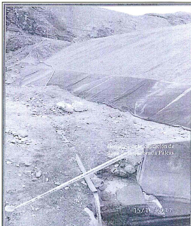
Fotografía N° 28: Hallazgo N° 2 y 3, Vista fotográfica de la descarga de las aguas (en la coordenada WGS84 N8568300, E521136) captadas en el canal de coronación, que provienen de la quebrada Palcas y filtraciones de los depósitos de desmontes de Chunchina y son dirigidas al sistema de bombeo del nivel 580.
