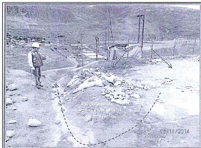
Fotografía N° 20: Hallazgo N° 1, se observa como escurre el agua proveniente de la Cancha de minerales hacia el canal de coronación que deriva las aguas de la quebrada Palcas.
