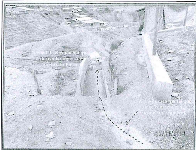
Fotografía N° 23: Hallazgo N° 1, en esta vista se observa el ingreso del agua que escurre de la cancha de mineral sobre el canal de coronación que deriva las aguas de la quebrada Palcas.
