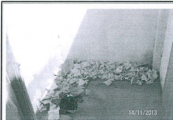
Fotografía 11: En la vista se observan residuos sólidos no peligrosos (papeles del SS.HH., bolsas plásticas), que se ubica en los SS.HH. de la empresa Grifo TATE S.R.L.
